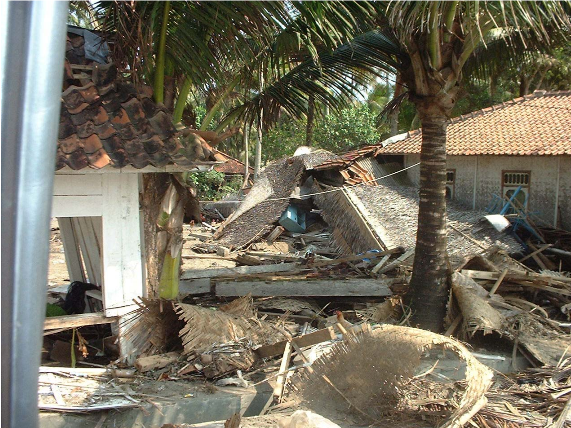
Gambar 1. Kerusakan rumah penduduk akibat tsunami di Kecamatan Pangandaran
